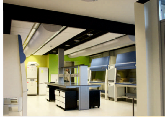
Ofis&İdari Bina Havalandırması
