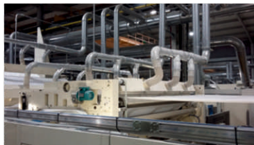
Proses Havalandırma Sistemleri
