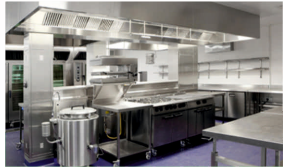
Mutfak Emiş ve Havalandırma Sistemleri
