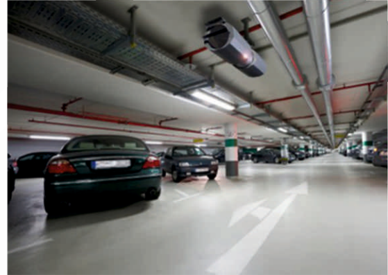
Otopark Havalandırma sistemleri
